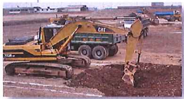
Foto N° 01: Vista en la que se observa la preparación de canchales con maquinaria
